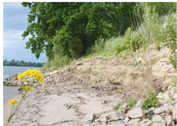
Uferabbruch in einer ehemals durch Steinwurf gesicherten Böschung
