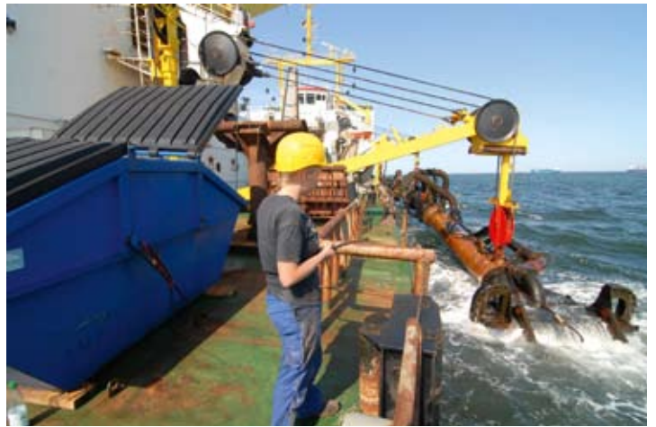
„Nordsee“ bei der Arbeit auf der Jade – Ein Saugrohr wird ins Wasser gelassen
