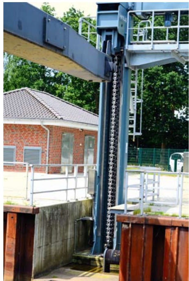
Hinter der Kammerwand: Stoßschutzsystem mit Elastomere – Fender
