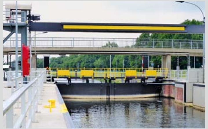
Stoßschutzanlage mit nach oben verfahrenen Balken
